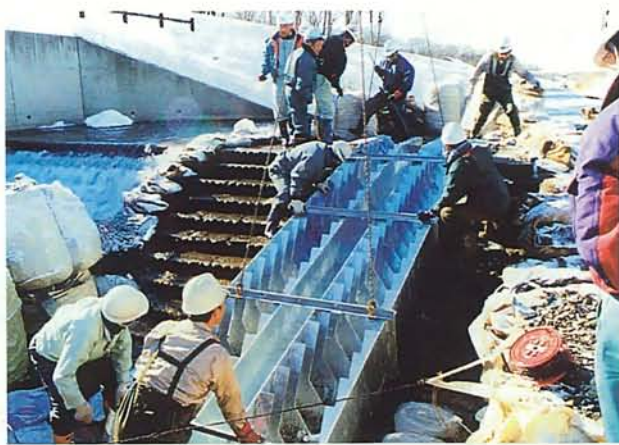
売買川で住民と一緒に簡易魚道を設置している様子(写真:十勝多自然ネット)
